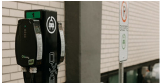
Volet développement durable : six nouvelles bornes pour véhicules électriques accessibles dans le stationnement arrière du Cégep. Merci au Groupe SGM automation!
